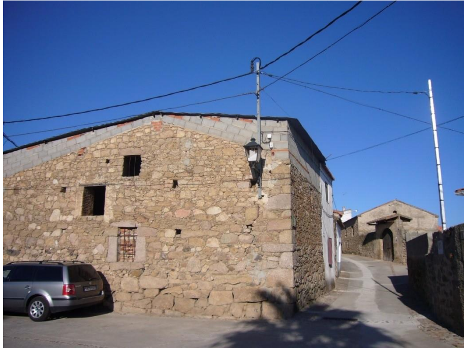
Edificio donde se observa el empleo de materiales tradicionales y modernos, junto con la presencia de abundante cableado.
